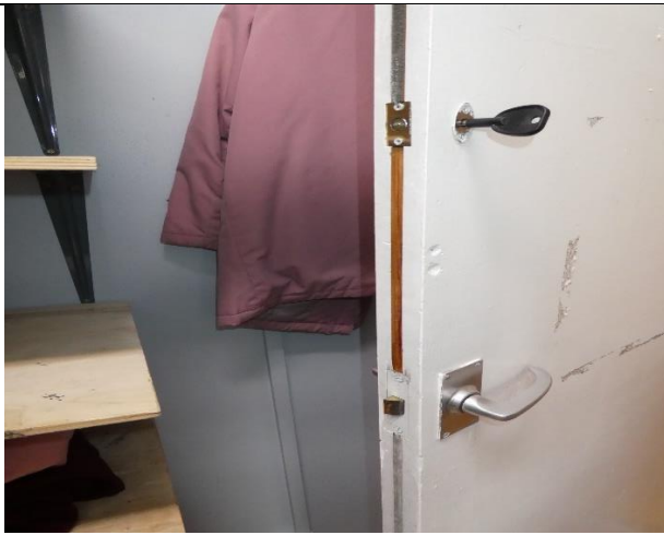
Photo 7 Laundry Door Intumescent strip
