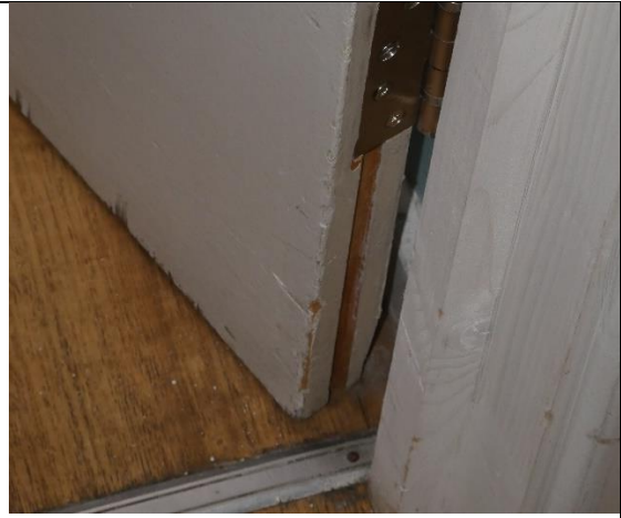
Photo 6 Laundry Door Intumescent strip
